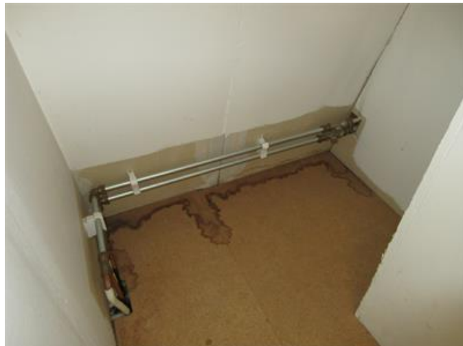
Missfärgningar på golv i klädkammare
