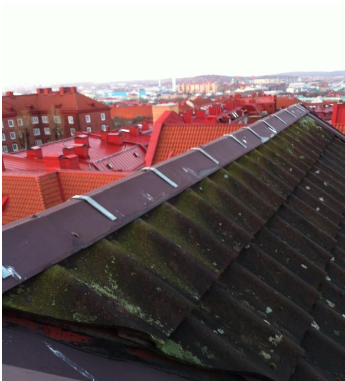
Beväxtning på pannor som indikerar fukt med frostrisk samt vatteninträngning från rännal
