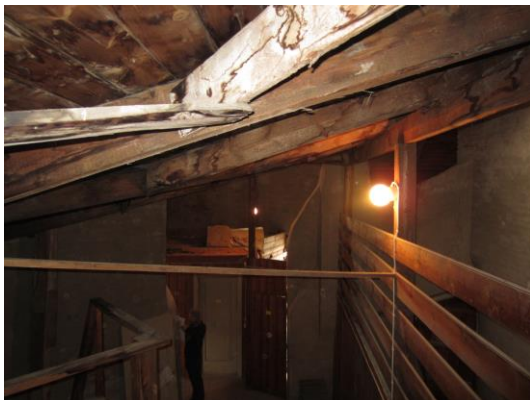
Exempel på angripna takbjälkar.
