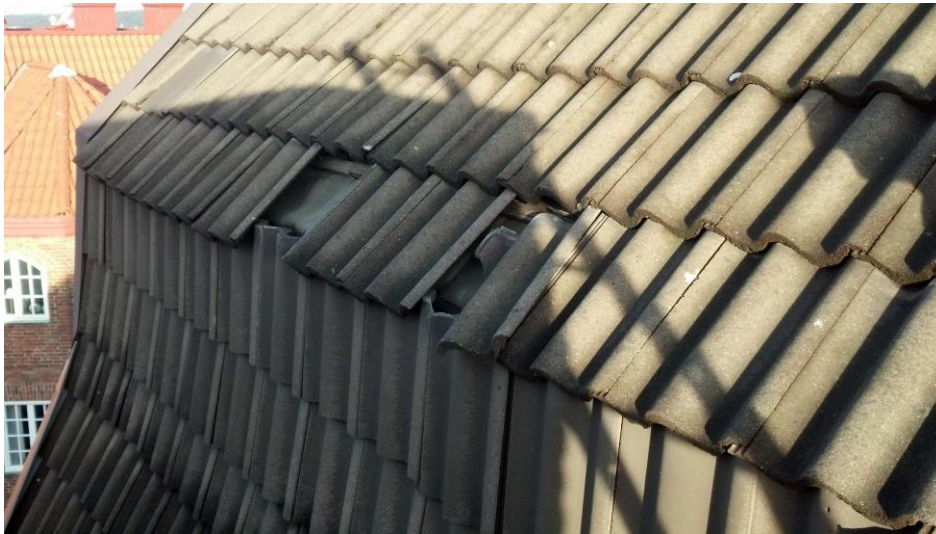
Pannor som lossat från läkten och ramlat ned
