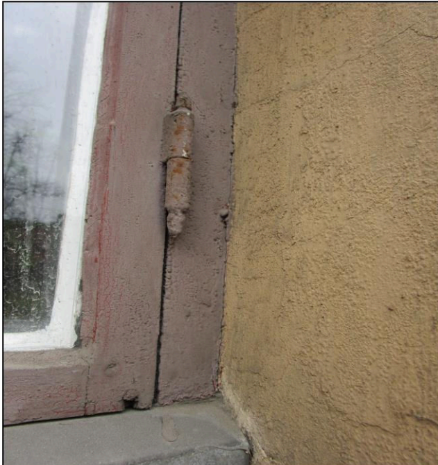
Träfönster i behov av renovering
