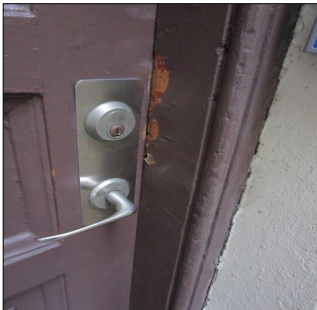
Dörr till B-huset med brytmärken och färgsläpp
