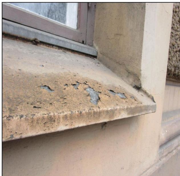
Fönsterbleck med färgsläpp
