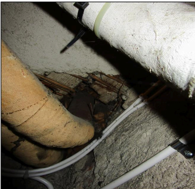
Rörisolering från denna tidsperiod innehåller sannolikt asbest i böjar
