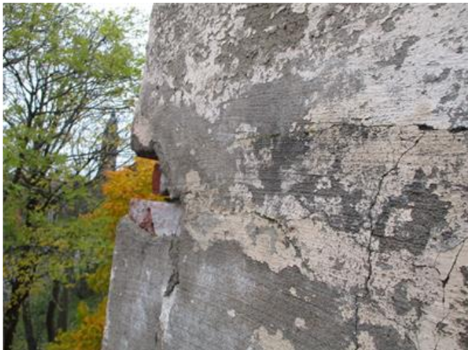
Bild visar putssläpp/sprickor i skorsten
