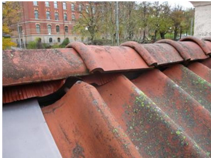
Bild visarnockpannor/band som tätar bristfälligt i nock
