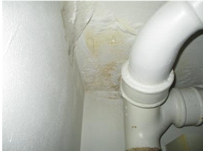
Bild visar missfärgningar i källartak i tidigare toalett
