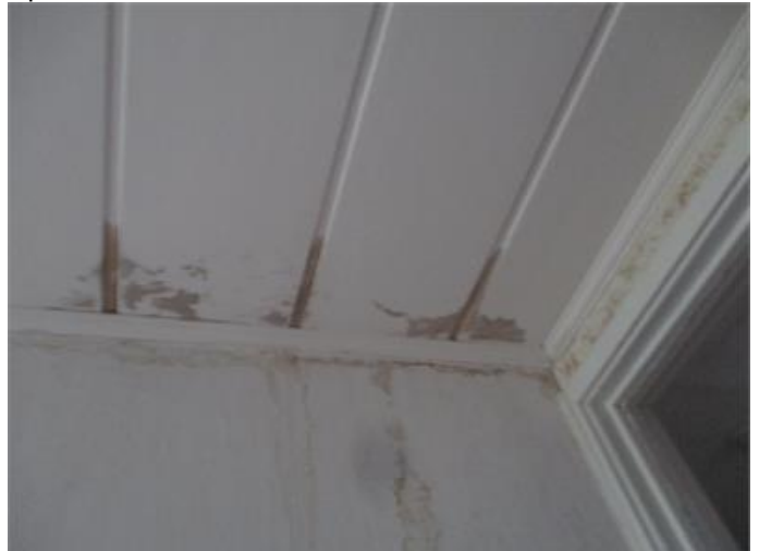
Missfärgningar i tak i gästrum under balkong
