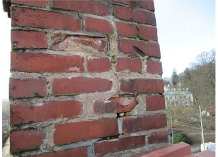
Sprickor i skorsten
