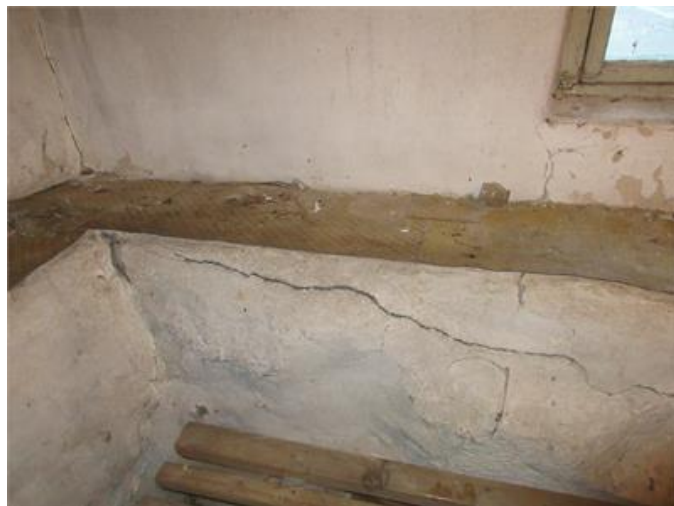
Exempel på sprickor i grundmur i källare
