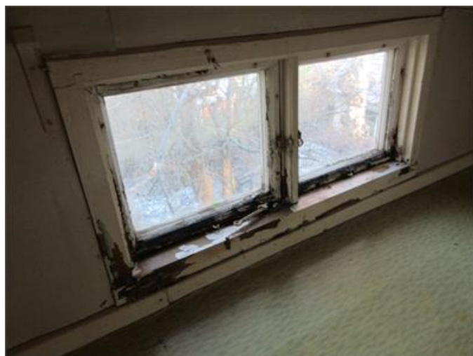
Exempel på fuktskadad fönster i sidovind
