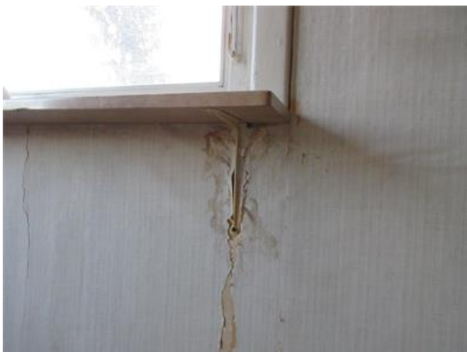
Exempel på missfärgning yttervägg under fönster
