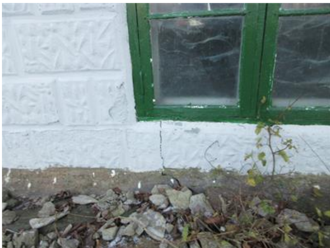
Exempel på sättspricka i grundmur
