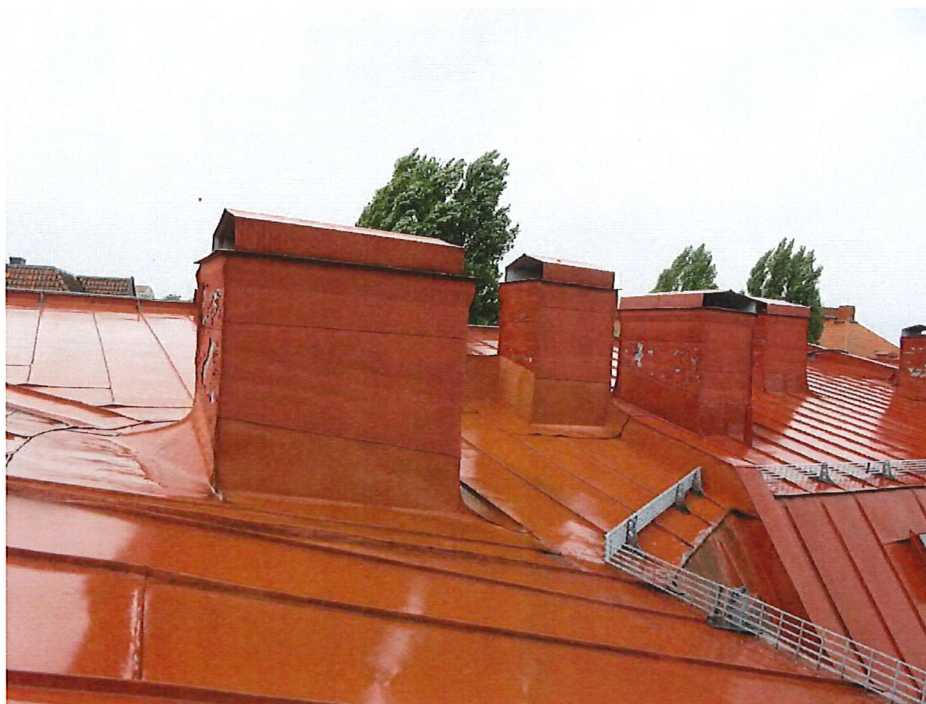
Färgen flagar på skorstenarna
