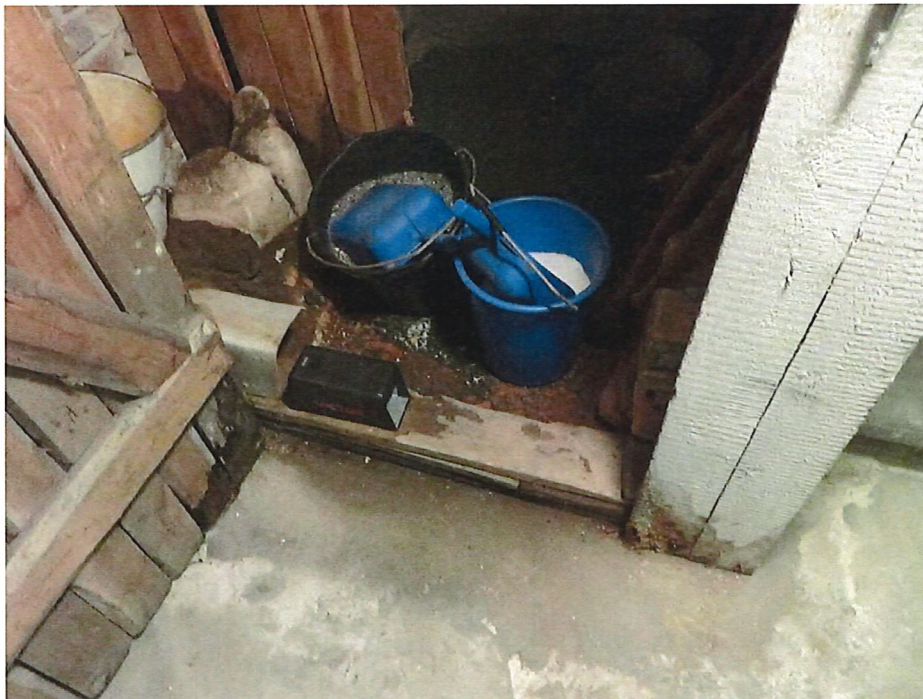
Vatten tränger in under trappan
