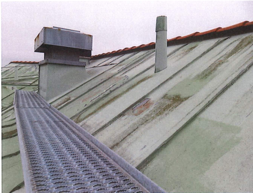
Yttertak i behov av rengöring och målning
