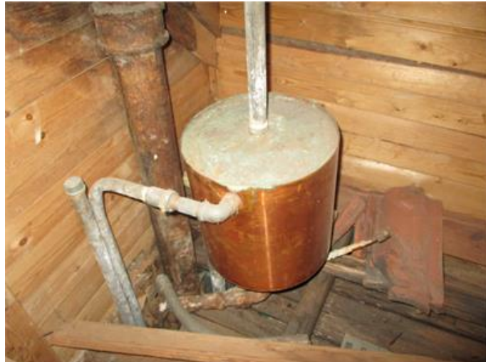
Röta i bjälklaget under expasnionskär i vind
