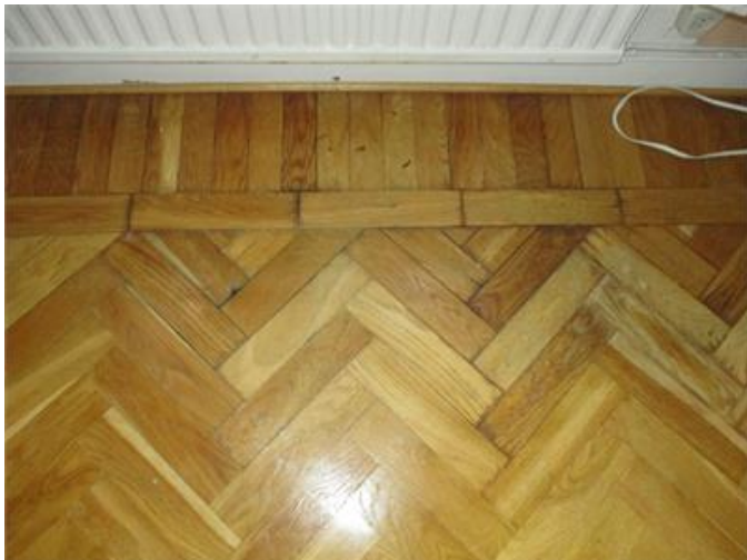
Missfärgad parkett i sovrum framför fönster
