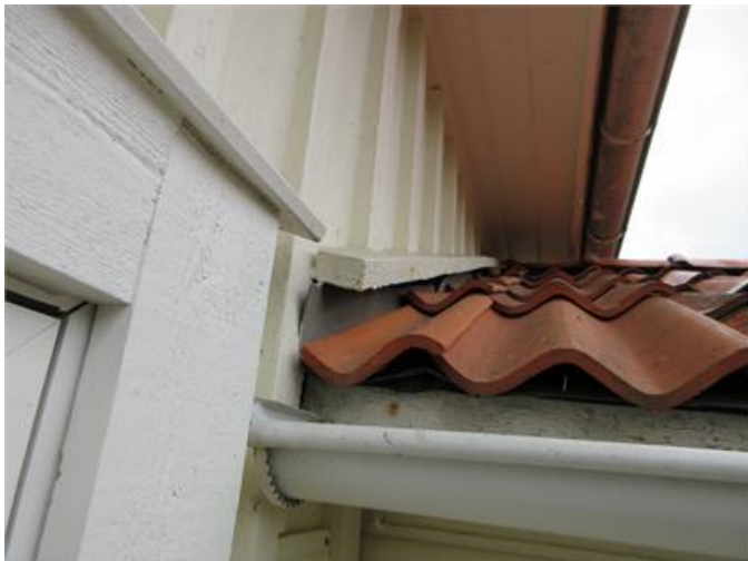
Brister i anslutning mellan tak och fasad
