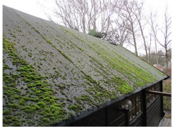
Mossa på taket
