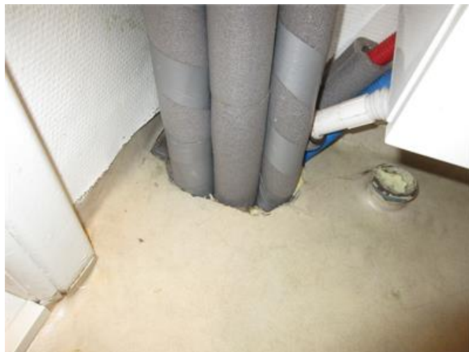
Upptaget hål i golv i tvättstuga
