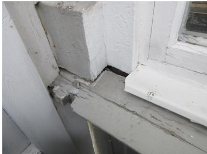
Vattbräda som släppt från fasaden
