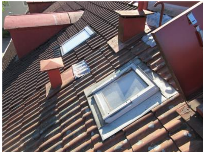
Plåtdetaljer med underhållsbehov
