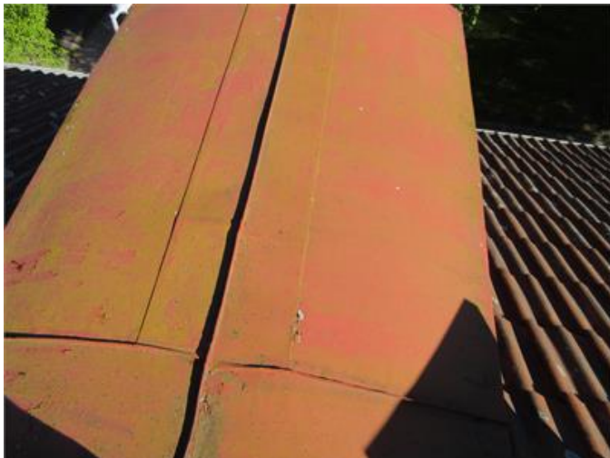
Bild visar takplåt med underhåll/målningsbehov
