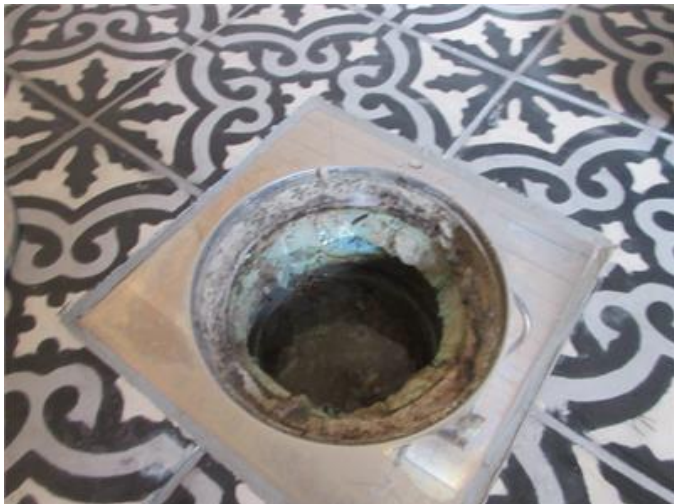
Golvbrunn i tvättstuga
