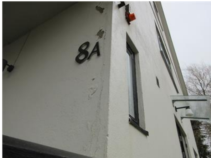
Exempel på sprickor i putsad fasad
