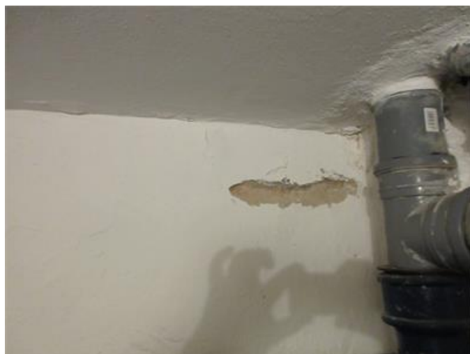
Puts/färgsläpp på yttervägg mot balkong i matkällare
