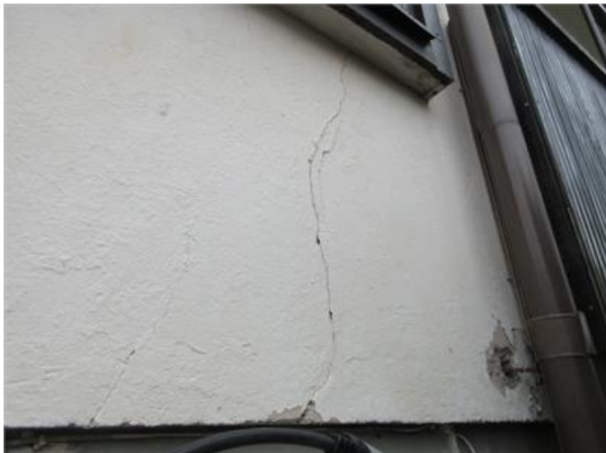
Exempel på sprickor i putsad fasad
