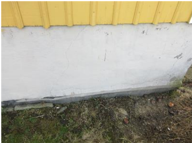
Exempel på putssläpp och sprickor i sockel
