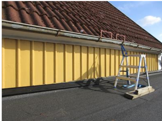
Brister i anslutningar mellan garagetak och husfasad
