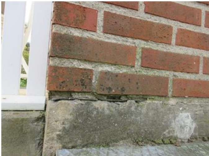
Exempel från frostsprängningar i sockel/fasad
