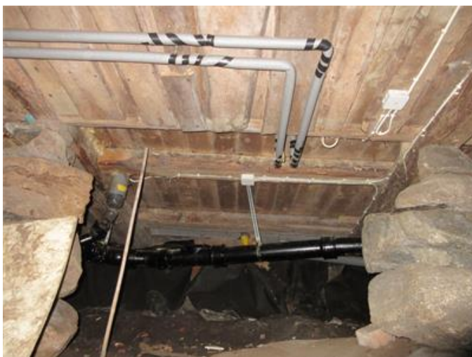
Oisolerat golvbjälklag i krypgrund
