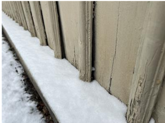
Fasadpanel/trädetaljer är i behov av målning/underhåll, glipor/otätheter förekommer.
