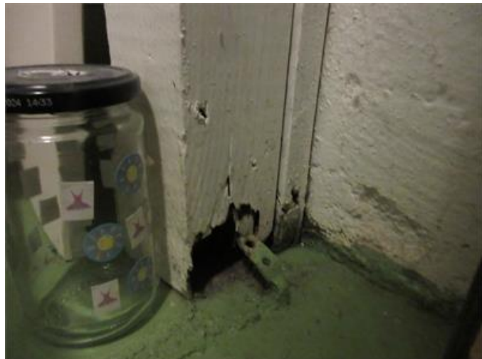
Röta i trästolpe i förråd
