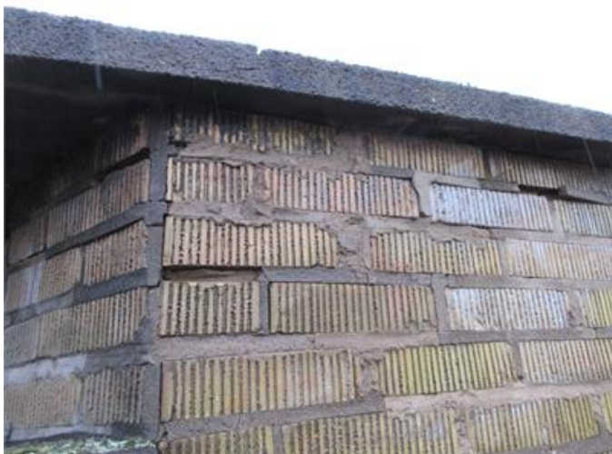
Fogsläpp/frostsprängningar i skorsten
