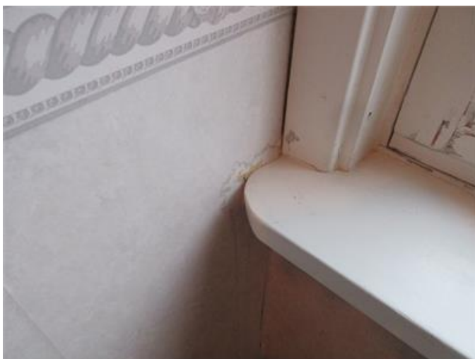
Missfärgningar på yttervägg i relaxrum
