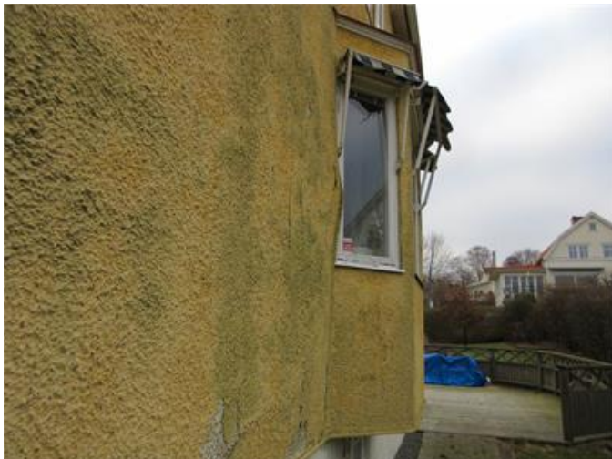
Putsfasaden har släppt från väggen
