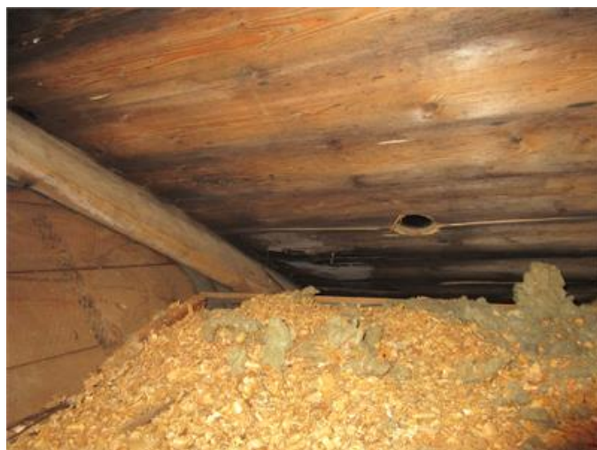
Röta i råsponttak i vind
