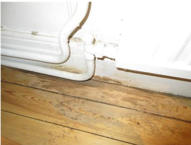
Missfärgning på golv under radiatorrör
