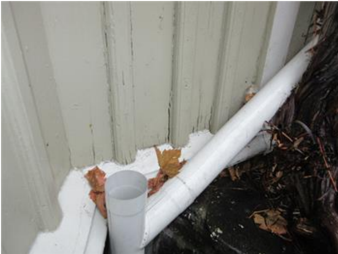
Bild visar exempel på röta i panel
