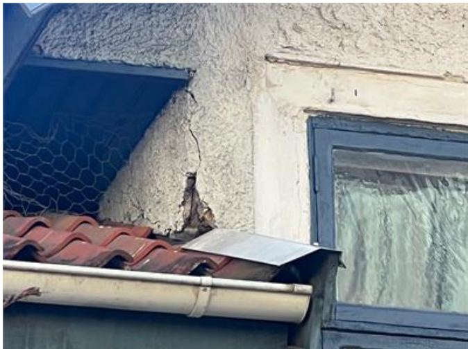
Exempel på sprickor/putssläpp i fasad.
